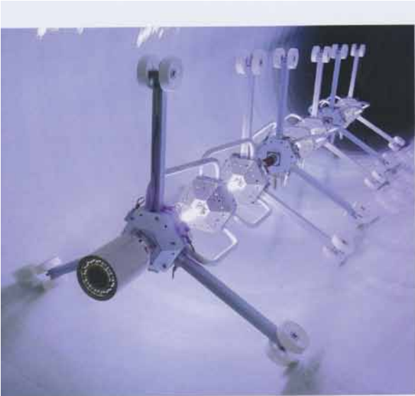
Lichtaushärtende Verfahren werden zunehmend bei der Sanierung von Abwasserrohren mit großen Nennweiten eingesetzt. | Foto: Relineurope AG
