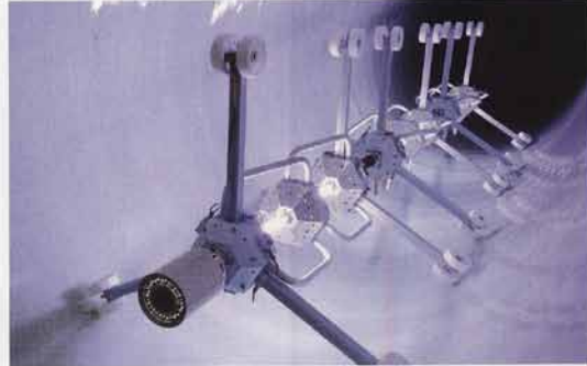
Lichtaushärtende Verfahren werden zunehmend bei der Sanierung von Abwasserrohren mit großen Nennweiten eingesetzt. | Foto: Relineurope AG
