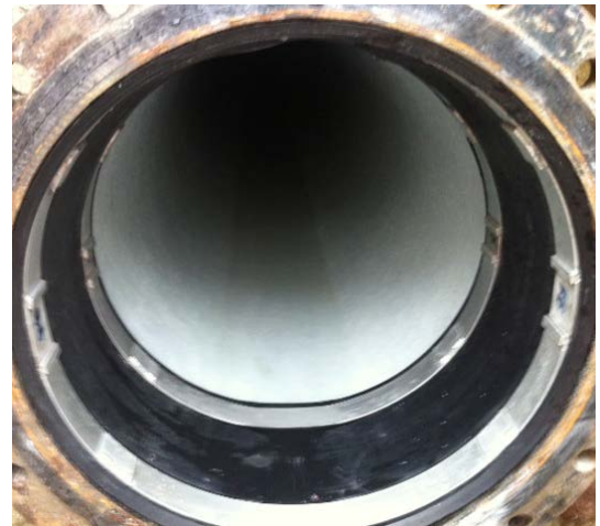
Bild 8: Manschette mit Edelstahlbändern hier: Druckrohr (Quelle: Fa. K Ingenieurbüro)
