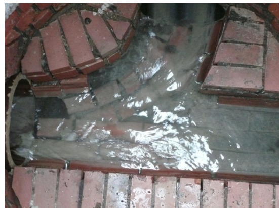
Bild 2: Hätten Sie die Fehlstellen im Gerinne von oben in Bild 1 gesehen?
