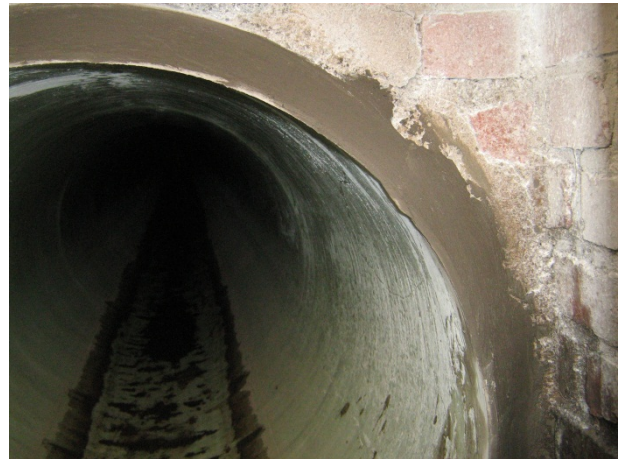
Bild 3: Rohranbindung mit Mörtel, schnell, günstig, aber haltbar?
